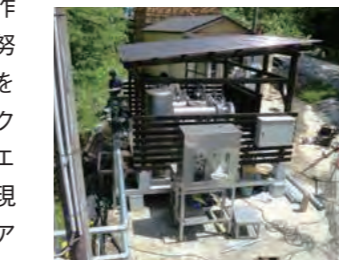
Fig.5 中山平地区で開発したバイナリ発電装置
