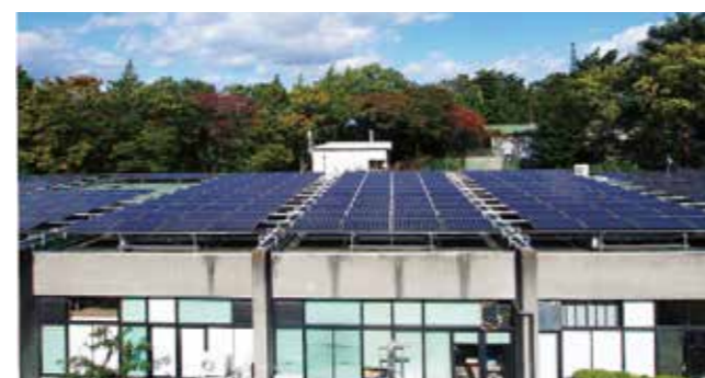
Fig.2 工場棟に設置された太陽光パネル (60kW/250W × 240枚)
