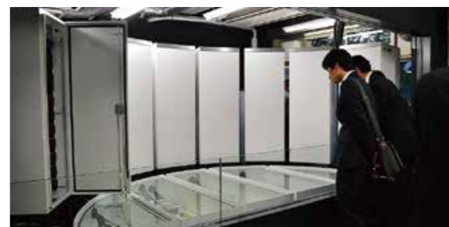
Fig.1 大型蓄電システム (蓄電容量: 57.6kWh (7.2kWh × 8))
