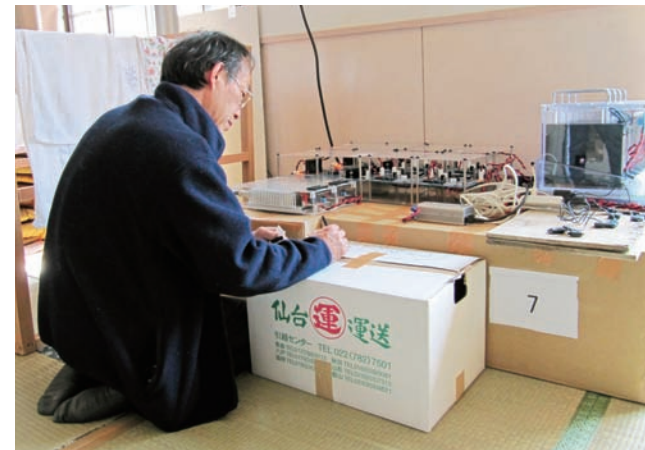
充放電システムを設置する田路教授
