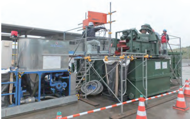
写真-1 実証試験に用いた分級装置と濁水処理装置
