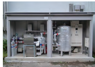
図2 向かって右側にあるタンクが温水貯蔵するバッファータンクで冬場の急速暖房など似利用する。左側のユニットがヒートポンプ
