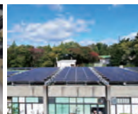
太陽光パネル
