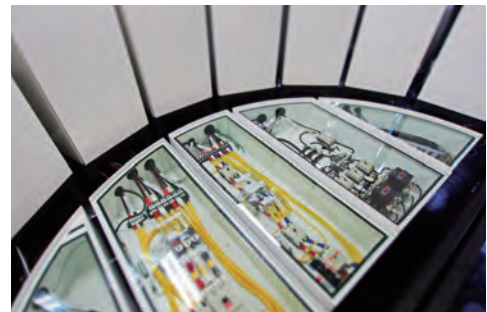
DC/AC ハイブリッド制御システム非常用切替盤
