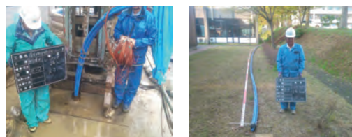
図3 坑井内にUチューブを挿入。このチューブ内を流体が循環し、地下との熱交換を行う
