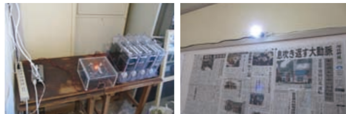
渡波中学校に設置した充放電システム 被災後初めて渡波中学校に灯った光
