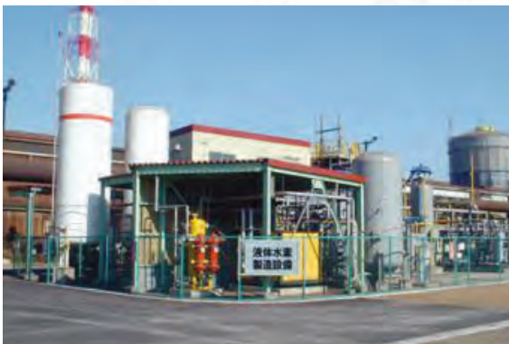
図1 液体水素製造設備（君津）*1
