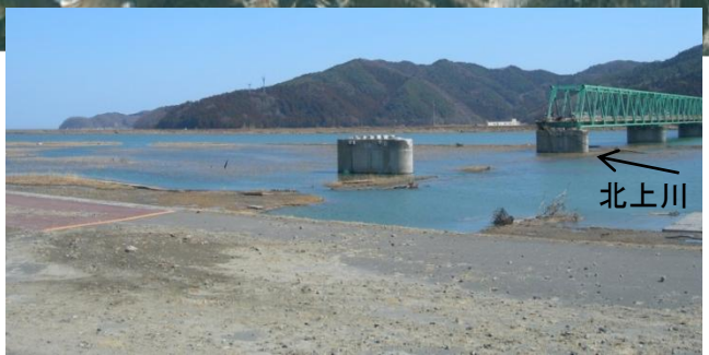
津波によって新北上大橋の左岸側2経間が流出 (3月19日撮影)
