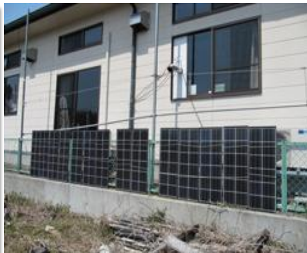
十三浜大指地区に設置した太陽電池パネル
