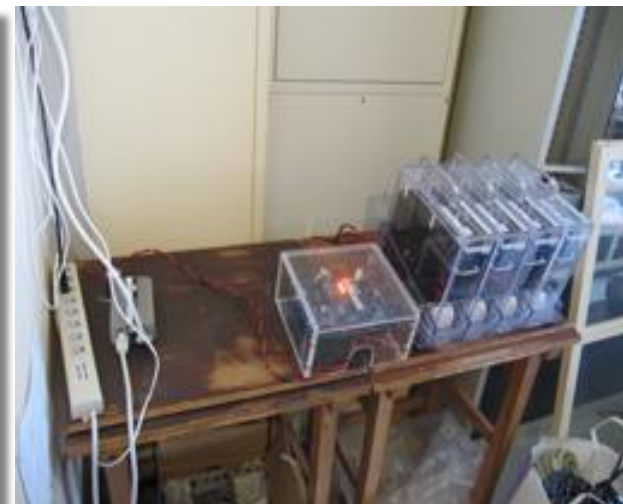
石巻市渡波中学校に設置した充放電システム
